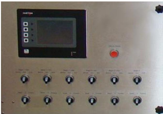
Elektrische Steuerung mit Datenlogger
