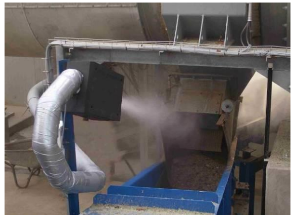
Staubbindungsanlage mit Frostschutz
