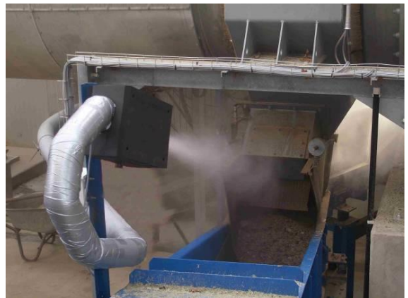
Staubbindungsanlage mit Frostschutz
